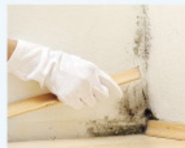
Nach Entfernung der Tapete und der Fussleiste wurde der Schimmelpilzbefall sichtbar
